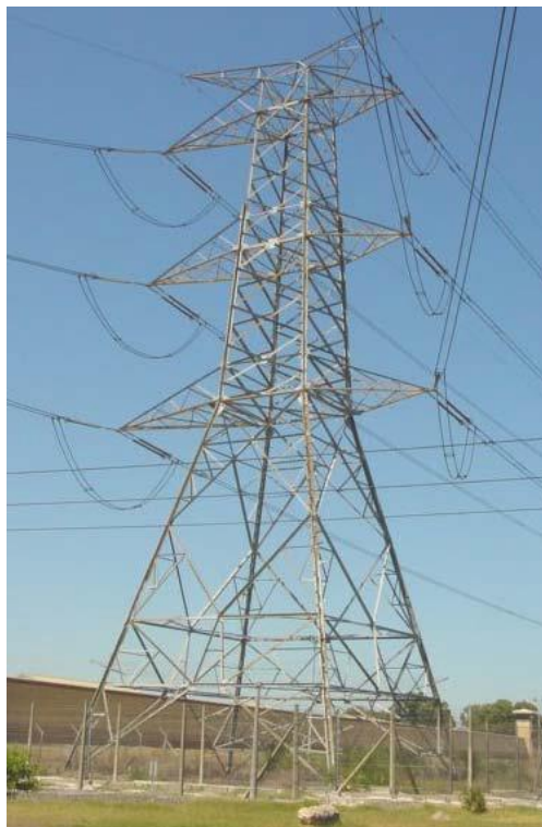
Πυλώνας 400 kV διπλού κυκλώματος
