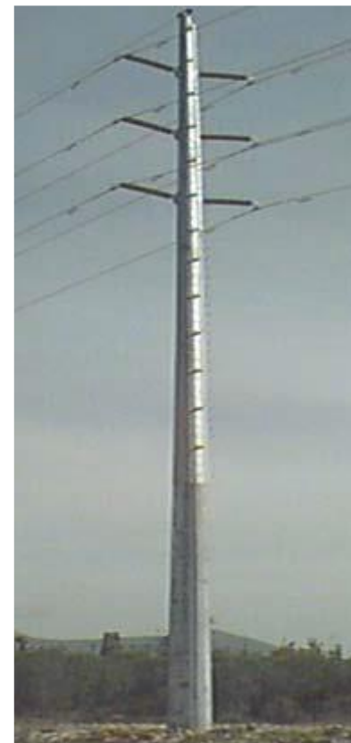
Πυλώνας 132 kV (νεότερη σχεδίαση)
