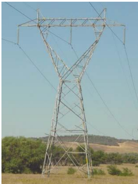
Πυλώνας 400 kV απλού κυκλώματος
