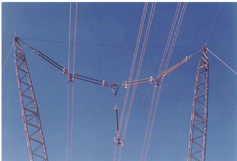
Πυλώνας 400 kV (νεότερη σχεδίαση)
