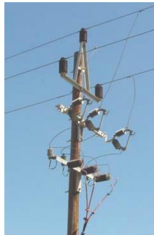
Διανομή 22kV (ξύλινος πυλώνας)
